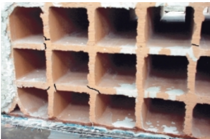
Campione tipo 1: fessurazione dei blocchi di laterizio sotto carico.
