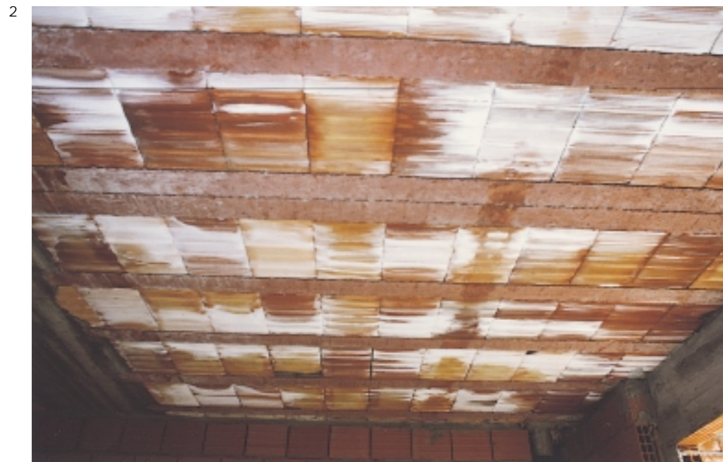
2. Efflorescenze saline sui blocchi di laterizio. Vanno accuratamente spazzolate prima dell'intonaco. Ancora meglio sarebbe non mettere in opera tali prodotti poiché il grado di efflorescenza è forte. 3. Macchie sull'intradosso del solaio dovute all'eccessiva efflorescenza dei blocchi di laterizio. 4. Prova di distacco della cartella inferiore di blocchi di laterizio (scartellamento) per effetto del solo ritiro della malta cementizia (ad alto tenore di cemento).
