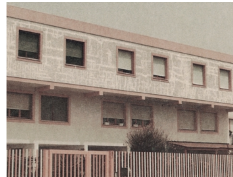
7. Intonaci fessurati per eccessivo soleggiamento (al primo piano) e integri (al piano terreno) perché protetti dallo sporto.
