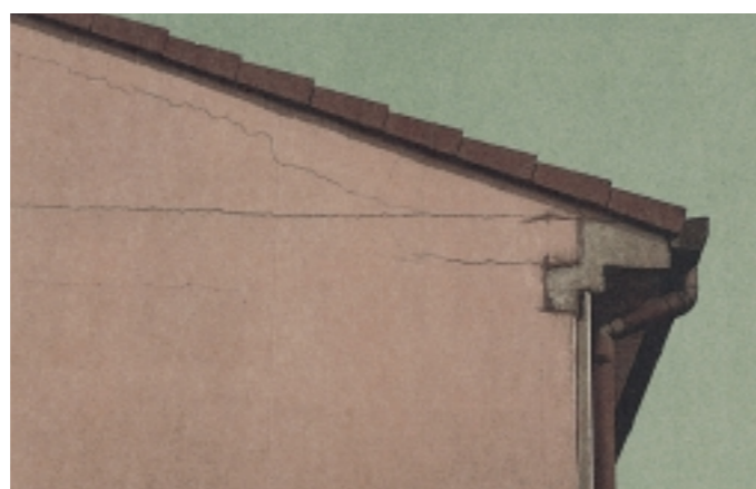
1. Fessurazione in corrispondenza del cordolo di solaio.
