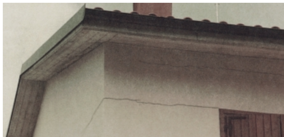
5. Fessurazione nell'angolo e in prossimità dello sporto in calcestruzzo.
