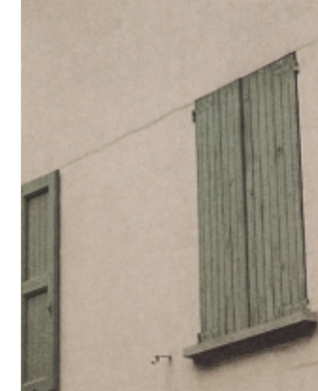
2. Fessurazione in corrispondenza dell'architrave delle finestre.
