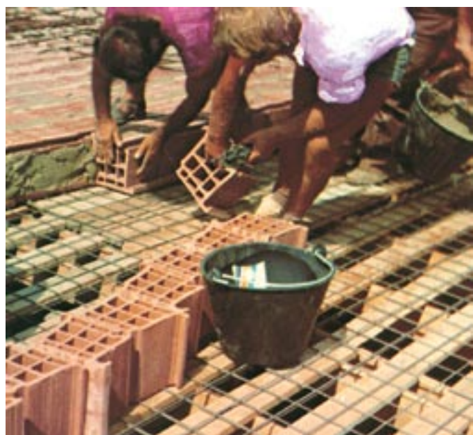
Posa dei blocchi sulla rete metallica predisposta sulle centine di guida degli archi.
