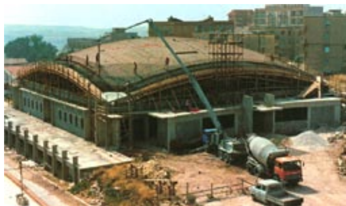
Una fase dei getti delle strutture di bordo e della soletta superiore in calcestruzzo a laterizio posato e murato.
