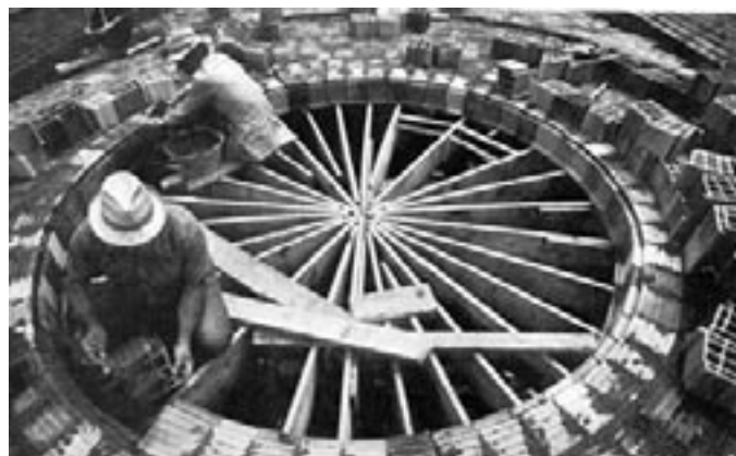
Una vista della zona centrale della cupola con la compensazione della calotta di colmo con raccordi in laterizio e getto in opera.
