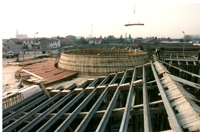
Travetti precompressi con blocchi interposti in laterizio su travi d'imposta in c.a. a profilo concavo
