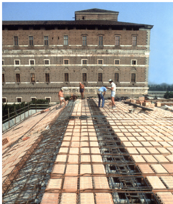
Orditura delle falde di colmo in travetti precompressi e blocchi interposti in laterizio
